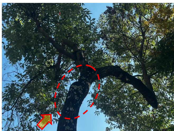
NO15 樟樹—腐朽(移除)
