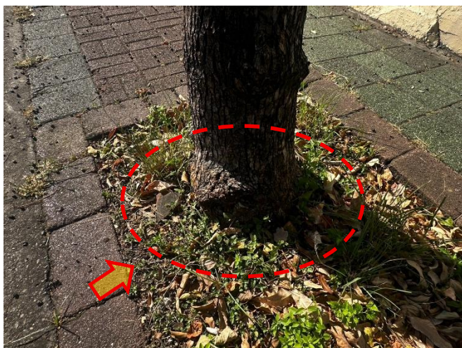
NO12 樟樹—腐朽(移除)
