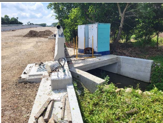
道路排水與灌溉溝渠採分離設計
